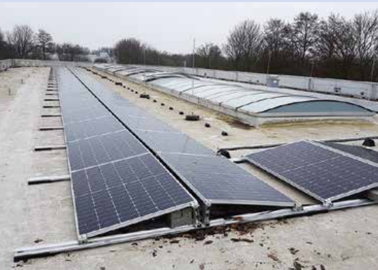
Neue Photovoltaikanlage in Betrieb 4 in Erkelenz
